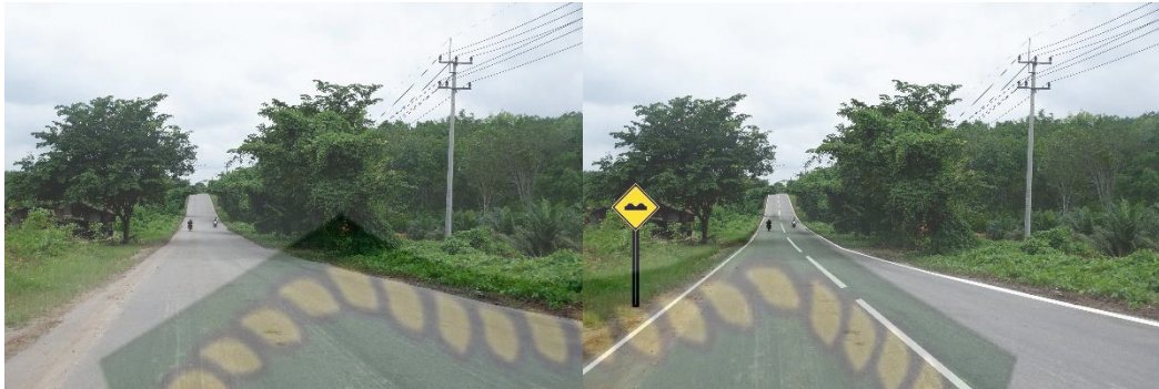
Gambar 5.27 Penanganan Berupa Pemasangan Rambu Lalu Lintas dan marka jalan di Segmen 5 (Dokumentasi, 2021).
