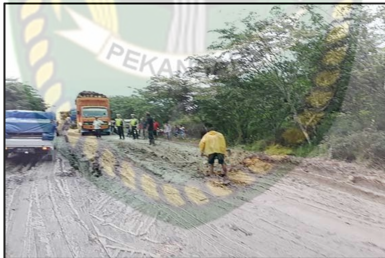
Gambar 3. 2 Jalan Rusak (Riaupos.com, 2018)
