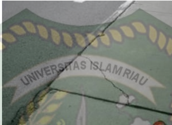
Gambar 3.7 Retak Sudut (Dokumentasi Peneliti,2020)
