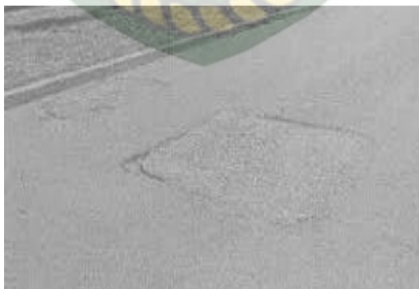
Gambar 3.6 Retak Blok (Dokumentasi Peneliti, 2020)
