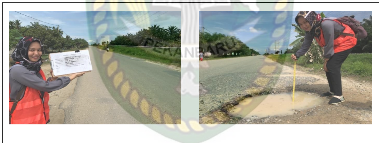
Gambar 5.4 Lubang STA 00+000 – 00+200 (Survey, 2020)
