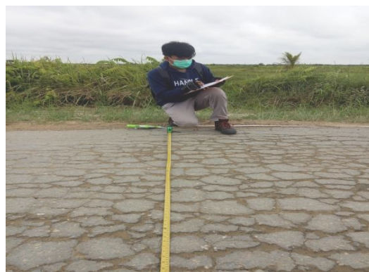
Gambar 3.12 Pengukuran Retak Kulit Buaya (Survei Lapangan)
