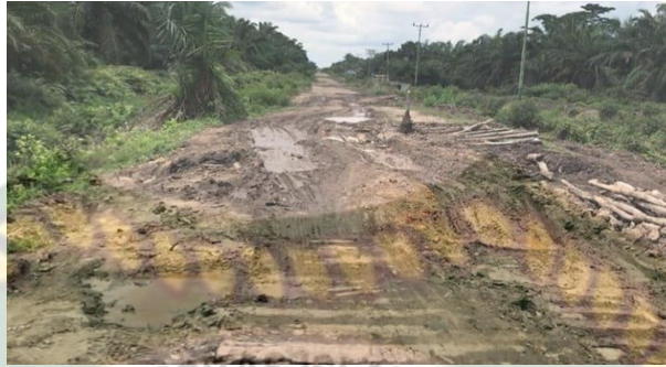
Gambar 4.2 kerusakan Pada Ruas jalan Desa sadar Jaya yang menuju ke Desa Muara Dua
