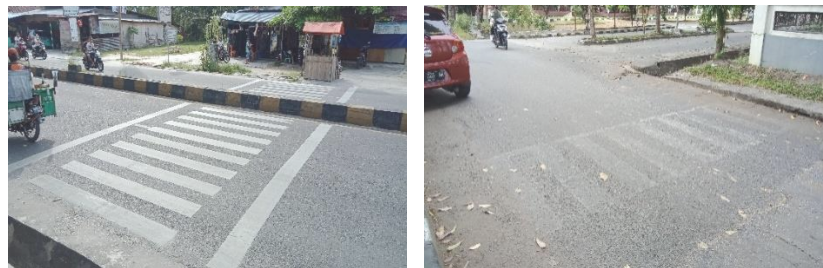
Gambar 5.2 Kondisi eksisting Zebra Cross yang berada Universitas Islam Riau dan di Jalan Jalan Kaharuddin Nasution
