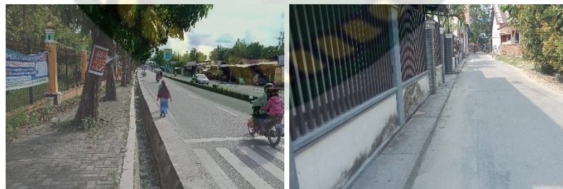
Gambar 5.3 Kondisi eksisting drainase baik tertutup maupun terbuka yang berada di sepanjang jalan
