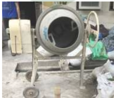
Gambar 4.12 Mesin Pengaduk Beton (Dokumentasi pribadi, 2019)
