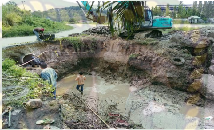
Gambar 10. Galian untuk Selokan Drainase dan Saluran Air (Sumber : PT. Hasrat Tata Jaya)
