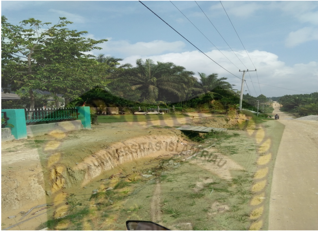
Gambar 14 : Kondisi Jalan dan Drainase yang Belum Selesai
