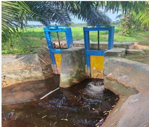
Gambar 4. Pintu Air Padi Pasang Surut Desa Pematang Sikek
