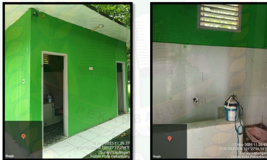
Gambar 5. 2 Kondisi Toilet Umum Sumber: Hasil Survey, 2025
