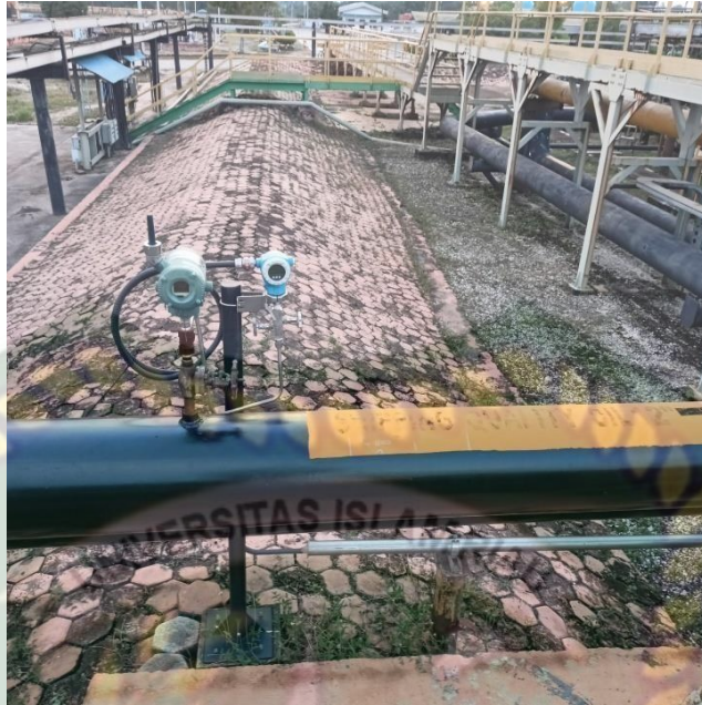
Gambar 4.2 Alat pressure transmitter pada Gathering station CGS 01
