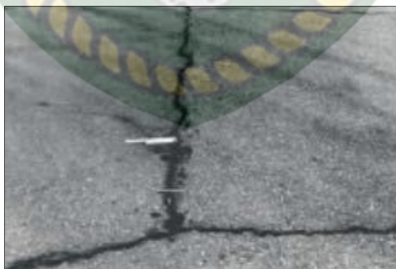
Gambar 3.11 Retak Sambungan ( Joint Reflec Cracks )
