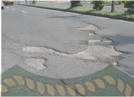
Gambar 3.4 Contoh Kerusakan Tekstur Permukaan ( delamination ) (Hardiyatmo, 2015)
