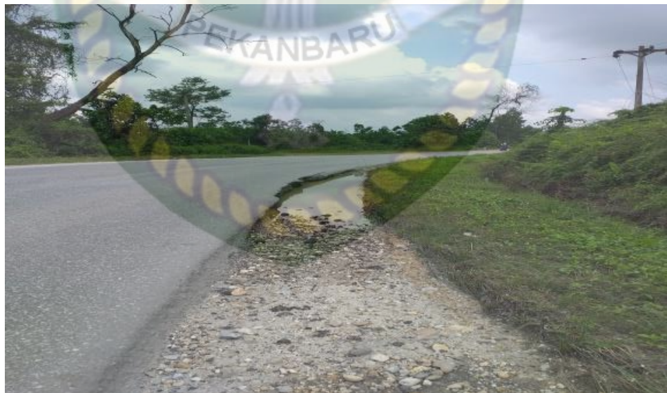
Gambar 5.2 Kondisi bahu jalan
