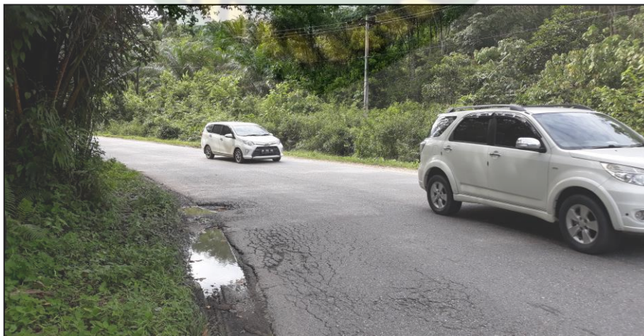
Gambar 5.5 Kondisi jalan pada Daerah yang rawan kecelakaan
