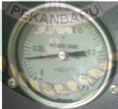
Gambar 3.7 Pressure Gauge Pada Penstock
