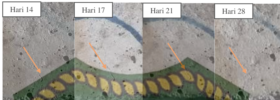
Gambar 5. 10 Pemulihan Retakan Beton Varian Bakteri 9%
