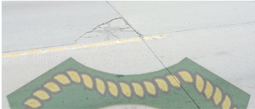
Gambar 3.10 Retak Sudut (Survei Lapangan)
