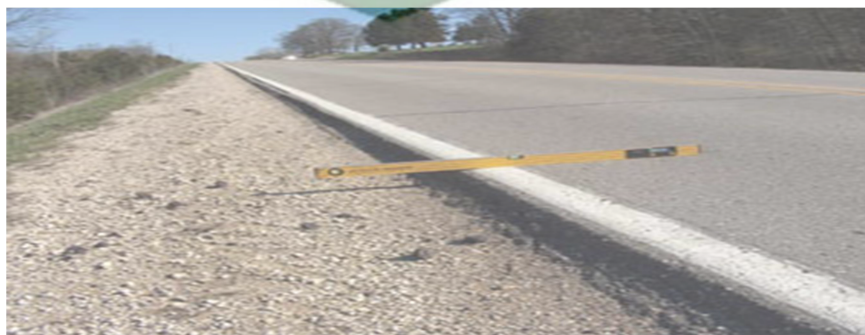
Gambar 3.15 Penurunan Bagian Tepi Perkerasan (Suryawan, 2009)
