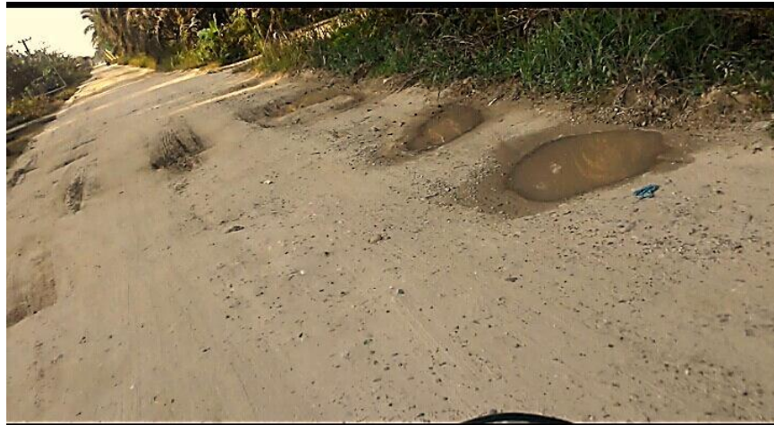
Foto Dokumentasi Jalan Poros yang Rusak di Desa Gerbang Sari Yang Menghubungkan Antar Desa.
