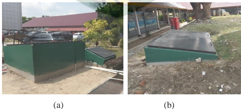
Gambar 5.5 (a) dan (b) gambar bak kontrol RSUD Arifin Achmad
