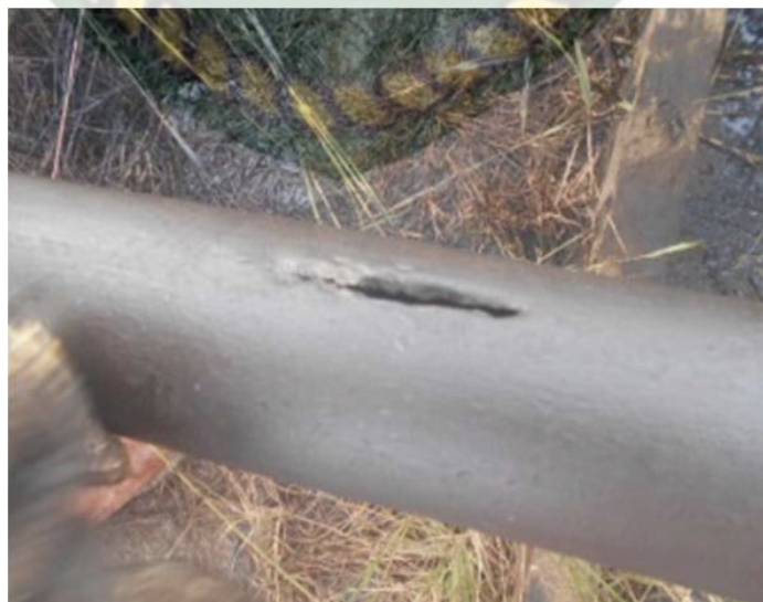
Gambar 4.5 Kondisi Tubing Leak pada Joint 99 dari Tubing Hanger .
