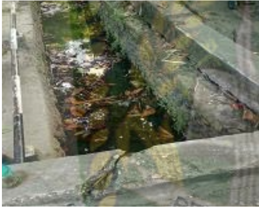
Sumber : Hasil Survey Lapangan, 2019 5.17 Gambar Kondisi Drainase
