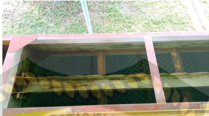
Gambar 3.5 Bak Penyaringan (Dokumentasi Lapangan)
