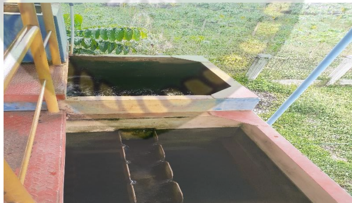
Gambar 3.2 Bak Koagulasi (Dokumentasi Lapangan)
