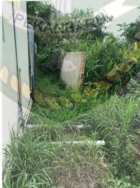
Gambar 4.7 Salah Satu Dokumentasi Kerusakan Bangunan Akibat Penurunan Tanah
