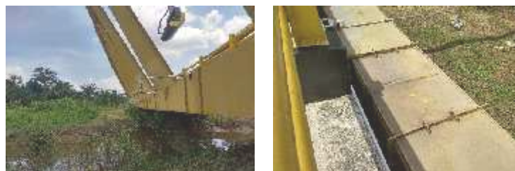
Gambar 5.3 Kondisi Edge Beam .
