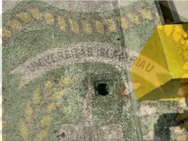
Gambar 5.7 Kondisi Pipa Cucuran
