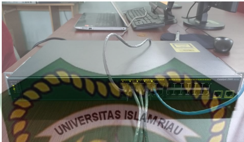
Gambar 4. 1 Instalasi Perangkat Keras Jaringan
