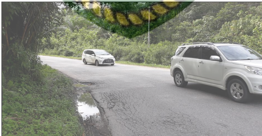
Gambar 5.5 Kondisi jalan pada Daerah yang rawan kecelakaan
