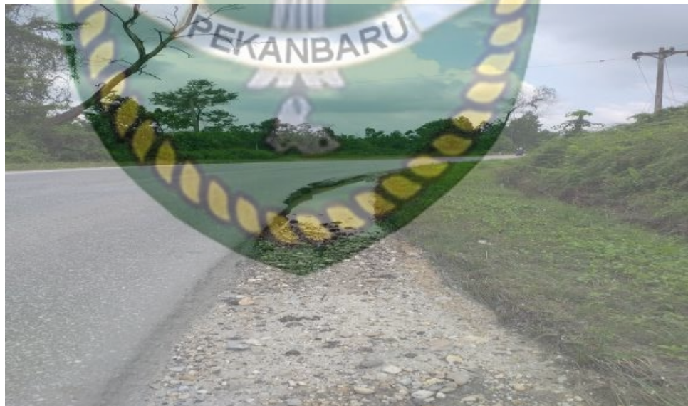
Gambar 5.2 Kondisi bahu jalan
