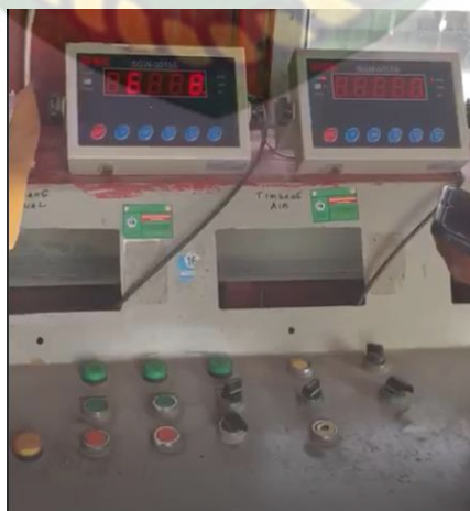
Gambar 5. 2 Panel monitor dan alat kendali (Dokumentasi, 2020)
